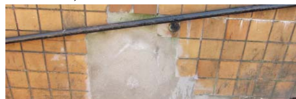
Klinker beskidte med grimme reparationer
