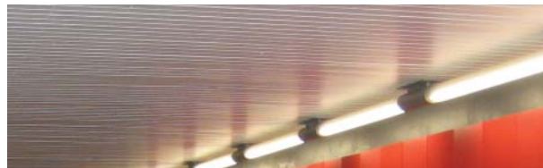
Belysning i tunnel, linjearmaturer
