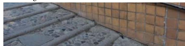
Slidt og ujævn belægning
