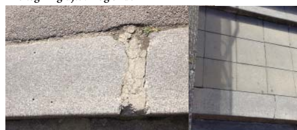
Trappe revnet og repos renoveret med forkert belægning
